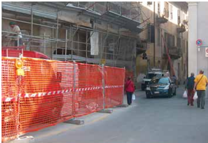
Il teatro Milanollo di piazza Turletti è già stato oggetto di lavori
