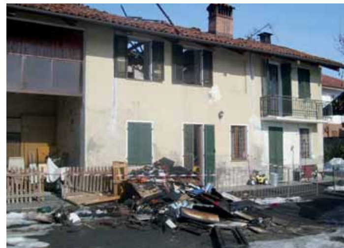
La casa colpita dalle fiamme: 40 mq di tetto sono crollati
