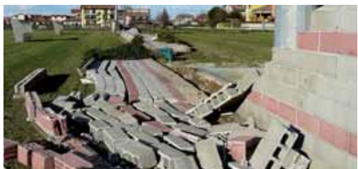
Muretto crollato allo stadio di Cavallermaggiore
